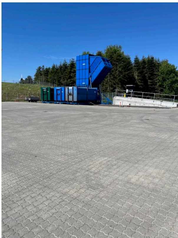
Komprimatoranlæg fra VARIG Teknik & Miljø, på Trolleborgvej.
